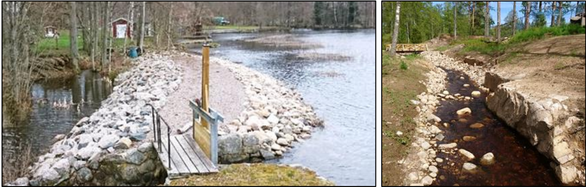
Figur 7. Exempel på en invallning som har skapats för att ge plats för en fiskvandringfåra, ett så kallat inlöp (t.v.) respektive ett så kallat omlöp som har schaktats fram i befintligt underlag och delvis genom sprängning (t.h.).
