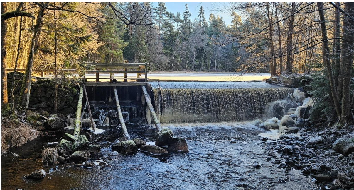
Figur 5. Fotografi av nedströmssidan av dammen, med de tre stöttorna som håller upp tråkassetten. Stöttorna är i dåligt skick, framför allt den mittersta som tydligt syns bögna.
